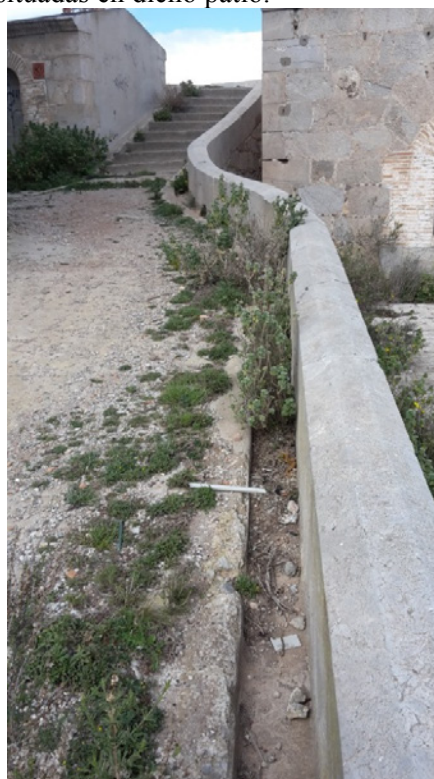
Figura 6. Sistema de recogida de aguas en rampa y escalera. Fuente: fotografía propia (2016).
