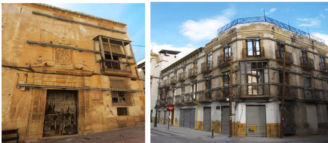
Figura 3. Muchos son aún los edificios históricos de propiedad privada que no han sido reconstruidos tras los seísmos de 2011, manteniendo sustentadas sus fachadas mediante grandes armaduras.
