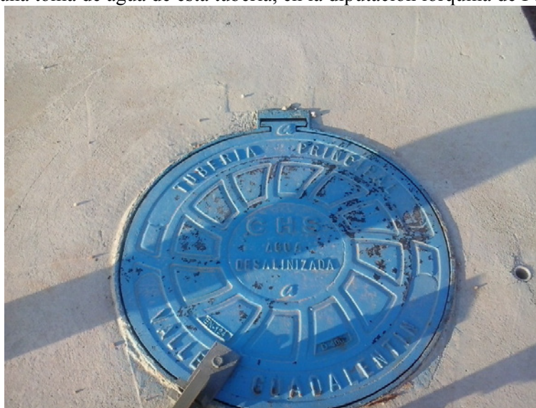
Figura 3. Toma de agua de la tubería de agua desalinizada del Valle del Guadalentín. Fuente: Fotografía propia
